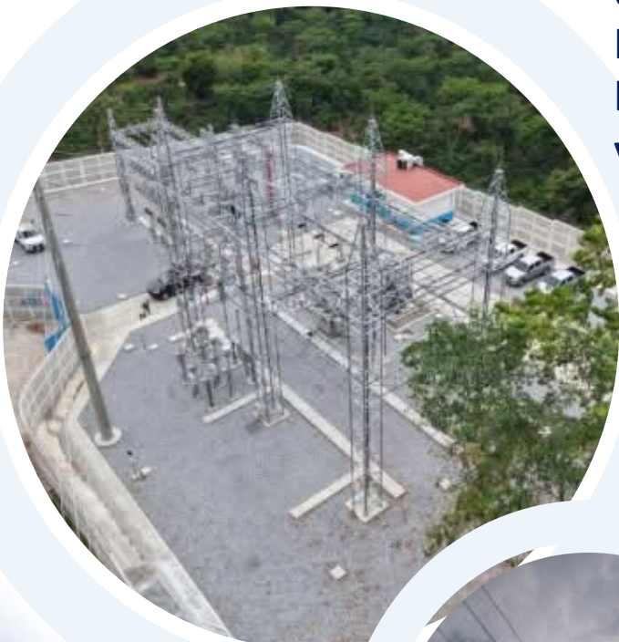
SE Chocolá Energización 12 marzo
