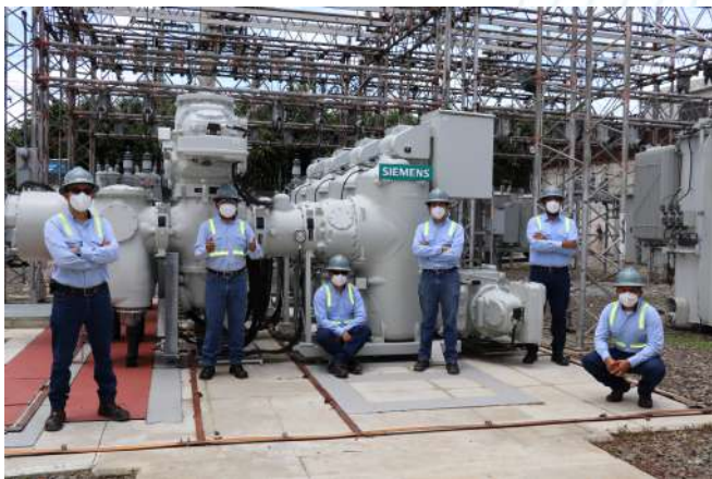
Amp. Subestación Monserrat 69 kV
