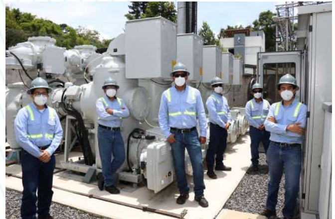
Amp. Subestación Tingo 69 kV
