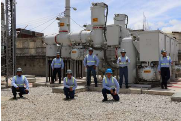
Amp. Subestación Minerva 69 kV
